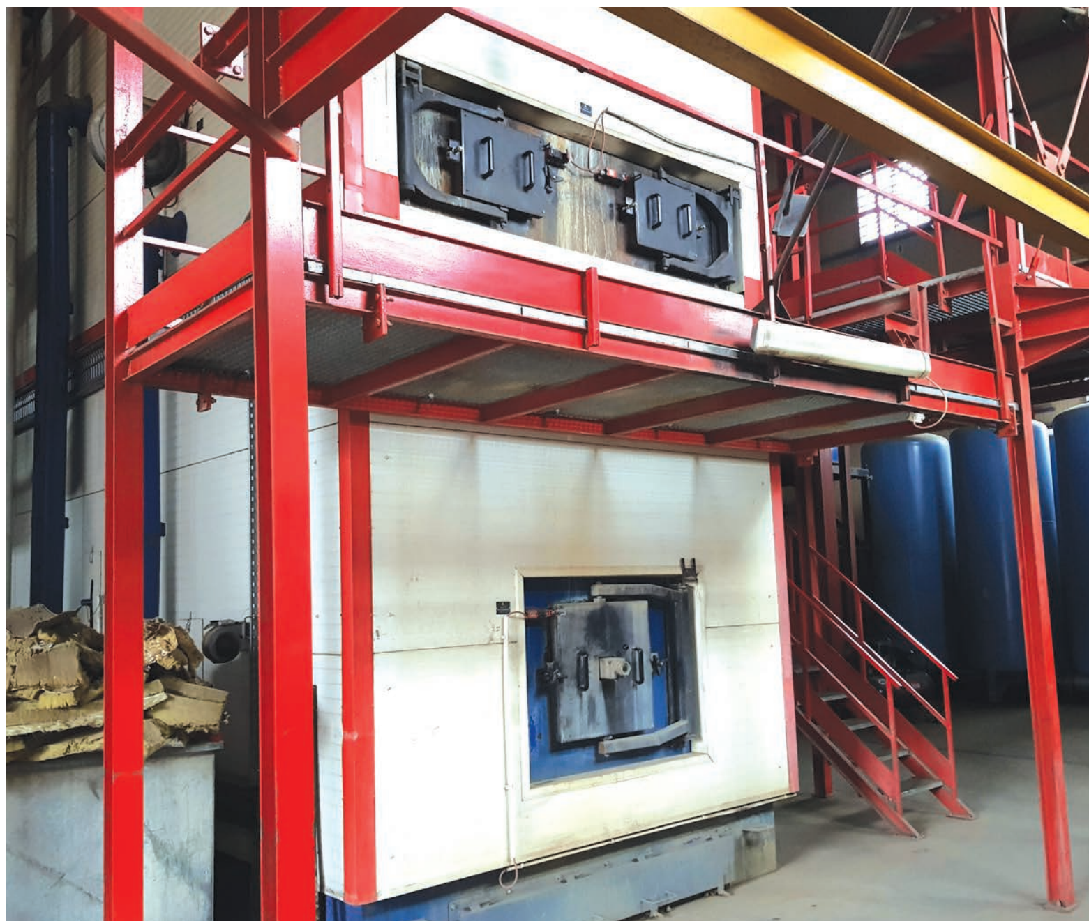
Az E-Star által rossz állapotban átadott mosztos kazánokat felújította az új szolgáltató
